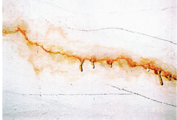
Manchas ferruginosas revelam que a infiltração atingiu as ferragens, o que pode condenar a edificação
