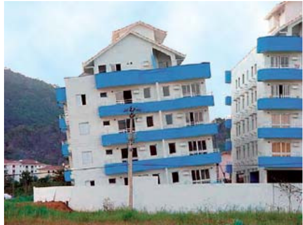
Problemas na fundação comprometeram o edifício em Ubatuba, SP, e causaram a demolição de todo o conjunto Foto: Arquivo/Paulo Grandiski
