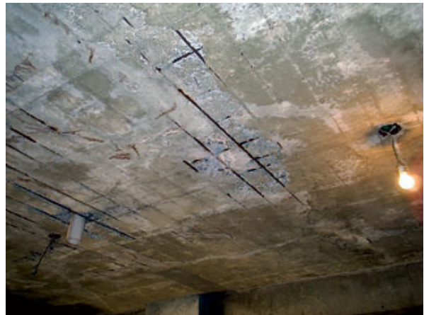
Obra com problemas de execução resultou em armaduras expostas na laje de cobertura
